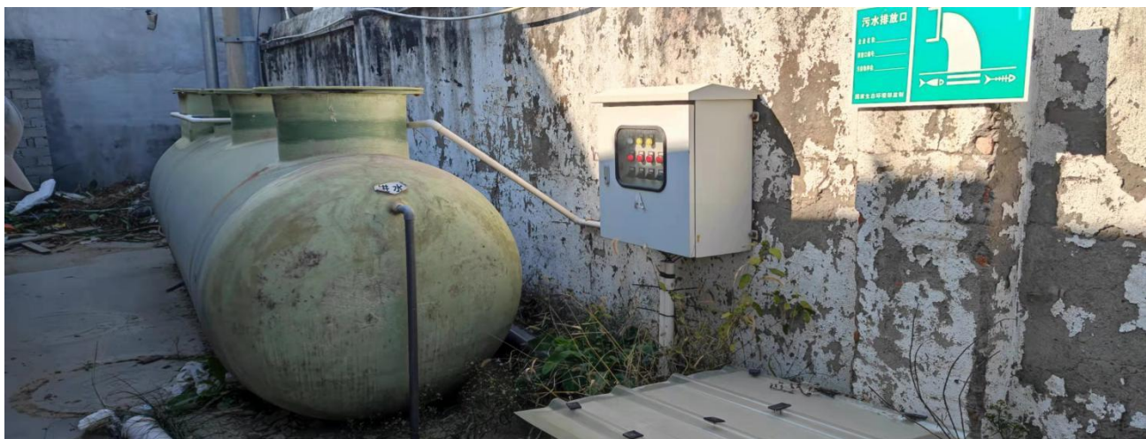
废水处理设施
